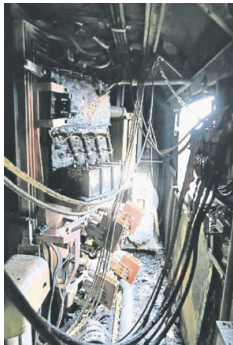
Totalschaden. Der ausgebrannte Maschinenraum. FOTO SUST
